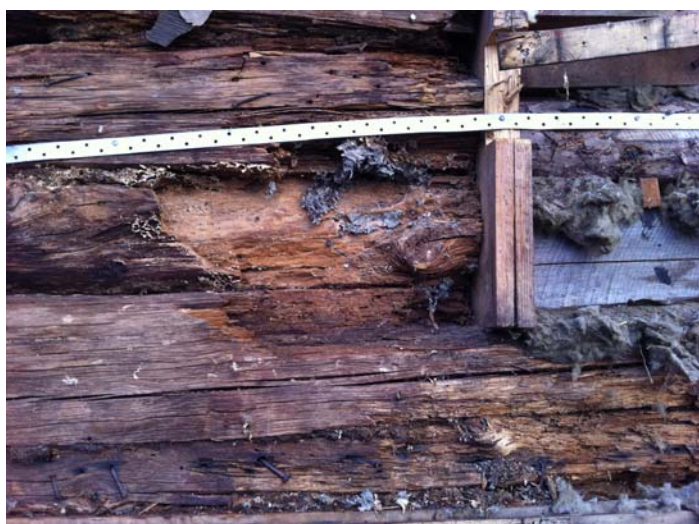
Delar av timmerstommen var angripen av röta. Södra fasaden.
