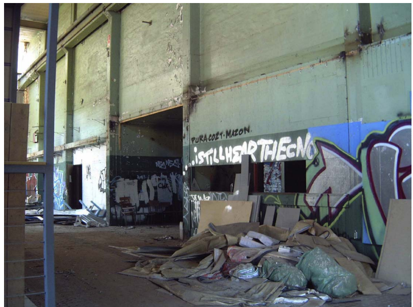
Svetshallens inre. Trots att en stor del av fönstren är igen- satta strålar ljuset in i lokalen. Till höger syns spår från rave-festerna med graffiti och en bar.
