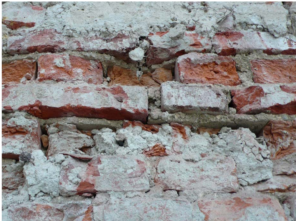
Tegelmur i blockförband med skador orsakade av frostsprängning och lagning med cementhaltigt bruk.
